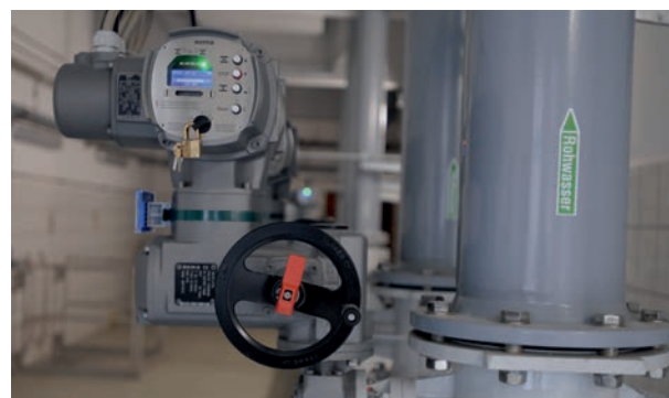
Rohwasserzuleitung im Wasserwerk: PM-Stoffe können aufgrund ihrer Eigenschaften in den Wasserkreislauf gelangen
