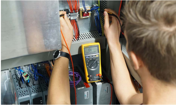
Arbeit im Schaltschrank der Leistungselektronik eines Speichersystems (Ishwar Sarpal, Leibniz Universität Hannover)
