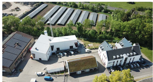
Stadtwerk Haßfurt – Eine PV-Anlage und ein Testgebäude des SIT4Energy-Projekts in Haßfurt, Deutschland
