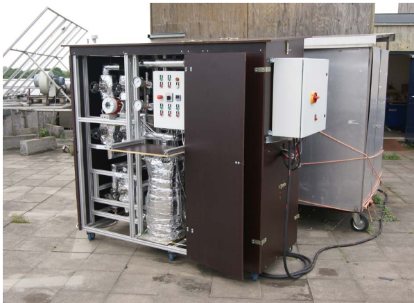
Konfiguriereinheit des am SIJ vorhandenen Hochtemperatur-Kollektoren-Prüfstands (bis zu 200 °C, 20 bar, 0,2 kg/s)
