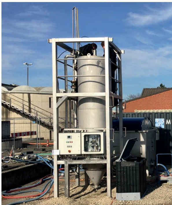
Ein dynamischer Sandfilter behandelt das Abwasser nach der biologischen Reinigung
