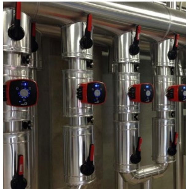
Ein Heizungsverteiler in einem Gewerbegebäude.
