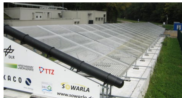
Die Demonstrationsanlage SOWARLA am DLR-Zentrum Lampoldshausen umfasst ca. 350 Quadratmeter. Sie dient der Wasseraufbereitung durch solare Photokatalyse.
