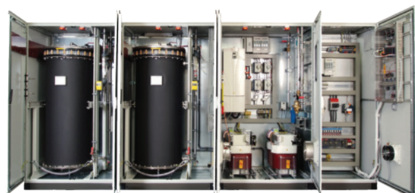
Eine modular aufgebaute Anlage trägt Ozon in das Abwasser ein
