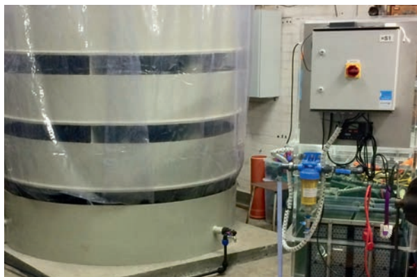
Demonstrationsanlage: Bodenfilter und Membrananlage sind kompakt in einem Kellerraum eingebaut.
