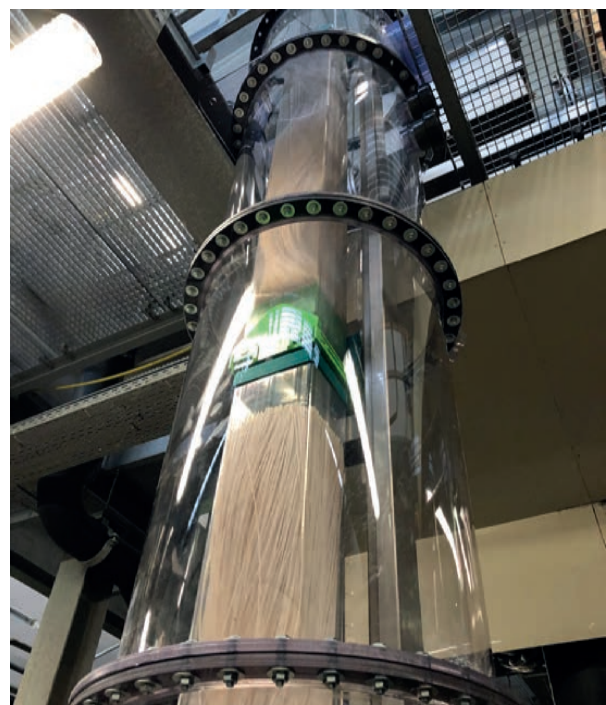
Pilotanlage für Membion-Doppeldecker-Hohlfasermodule auf der Kläranlage Konzen (Eifel)
