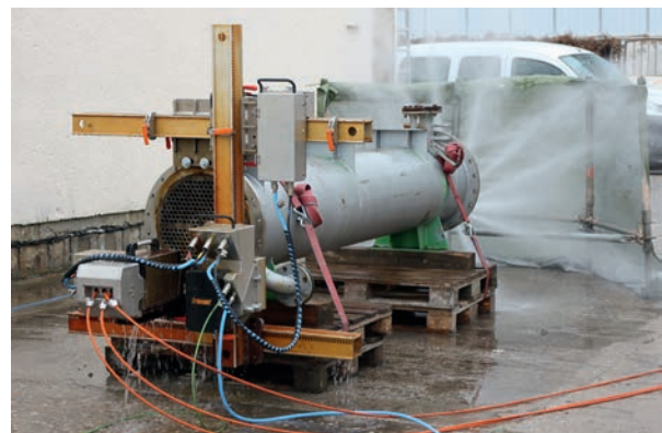
Ein Wärmetauscher wird vollautomatisch mit Hochdruckwasser gereinigt
