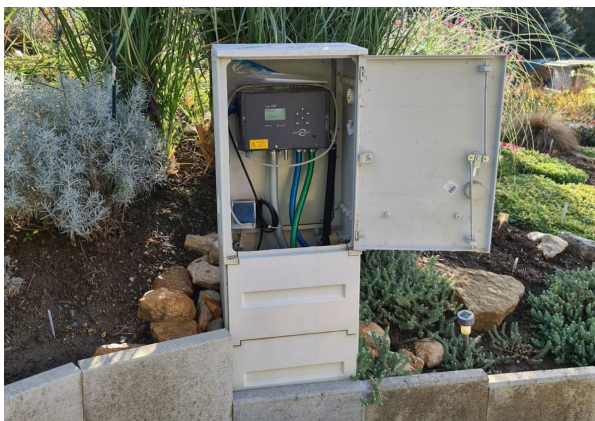
Beispiel einer Kleinkläranlagen-Steuerung, die mit dem KKAOnline-System ausgestattet werden kann.
