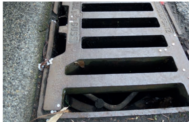
Kleine Kunststoffkugeln – so genannte Pellets – gelangen aus kunststoffverarbeitenden Unternehmen in die Kanalisation
