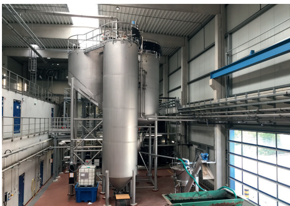
Großtechnische Struvit-Anlage auf der Kläranlage Braunschweig
