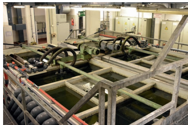
Aktuelle Abwasserbehandlungsanlage der Volkswagen AG am Standort Braunschweig mit einem Durchsatz von 150.000 m 3 im Jahr
