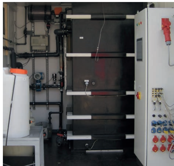
Das Verbundprojekt PU 2 R bereitet häusliche Abwässer in einem mobilen Membranbioreaktor (MBR) auf
