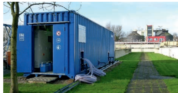
In der Pilotanlage auf dem Klärwerk Nordenham testen die Projektpartner Verfahrenskombinationen mit Ultrafiltration und Umkehrosmose.
