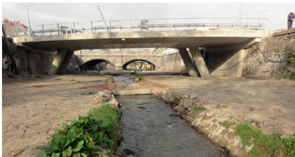
An dieser Brücke in der Innenstadt von Sofia wurde eine Messstation mit Radarpegel installiert.
