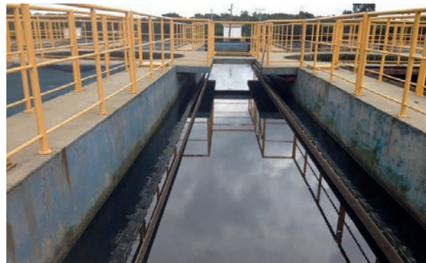
Ein UASB-Reaktor (Upflow Anaerobic Sludge Blanket) zur Reinigung von Abwasser und Erzeugung von Biogas
