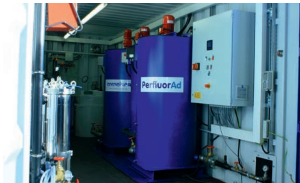
Das neue Verfahren wird in einer mobilen Anlage für die Aufbereitung PFC-haltiger Wässer getestet.
