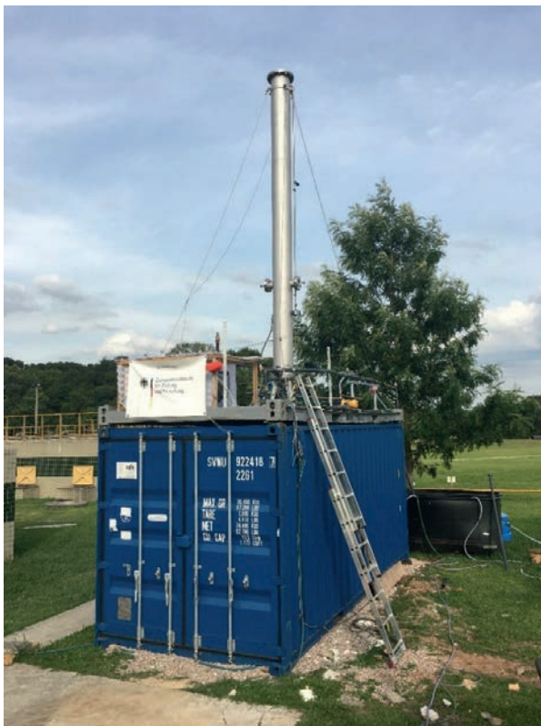
Auf der Kläranlage Padilha Sul in der brasilianischen Stadt Curitiba wird in einer Pilotanlage Methan aus Abwasser zurückgewonnen.
