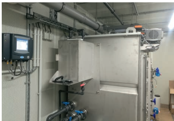
Das neue Regelungskonzept wird in einer Pilotanlage für die Aufbereitung kommunaler Abwässer getestet
