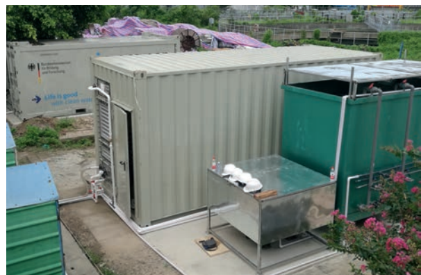
Eine MBR-Pilotanlage für die Abwasserbehandlung an einem chinesischen Standort
