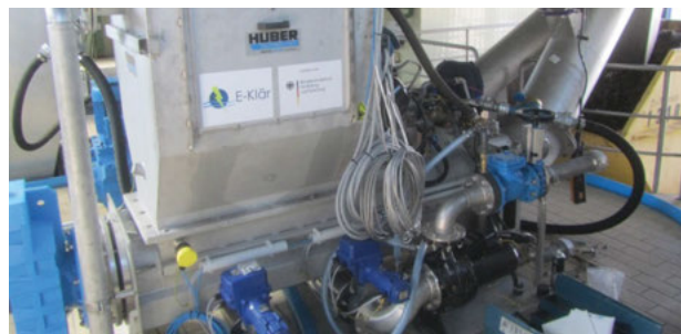
Abb. 1: Rechengutwaschpresse zur Kohlenstoffausschleusung
